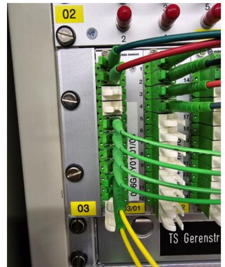
Abbildung 1: Zu ersetzender, in die Jahre gekommener Kabelendverschluss
