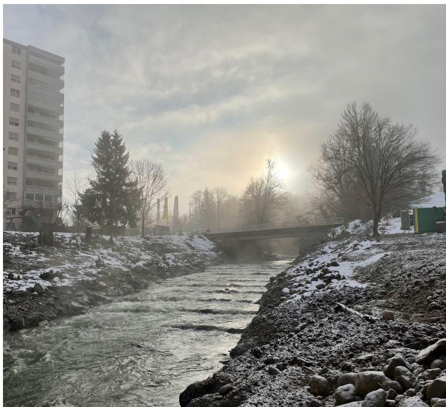
Die neu gebaute Rampe im Herbst 2023. Dank dem Abbau der alten Schwelle können Fische in der Glatt wieder von der Mündung bis in den Oberlauf gelangen.
