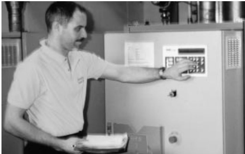
Badmeister Daniel Seitz überträgt die Betriebsdaten des Blockheizkraftwerkes in die Energiebuchhaltung.
